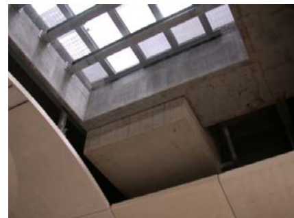
▲ Réserve dans la dalle supérieure pour le module de désenfumage statique
