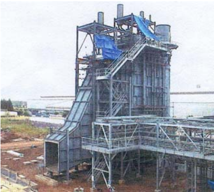
▲ Figure 1 : Vue de l'installation
