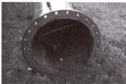
2. Dépôts colmatants dans le gaz CK
